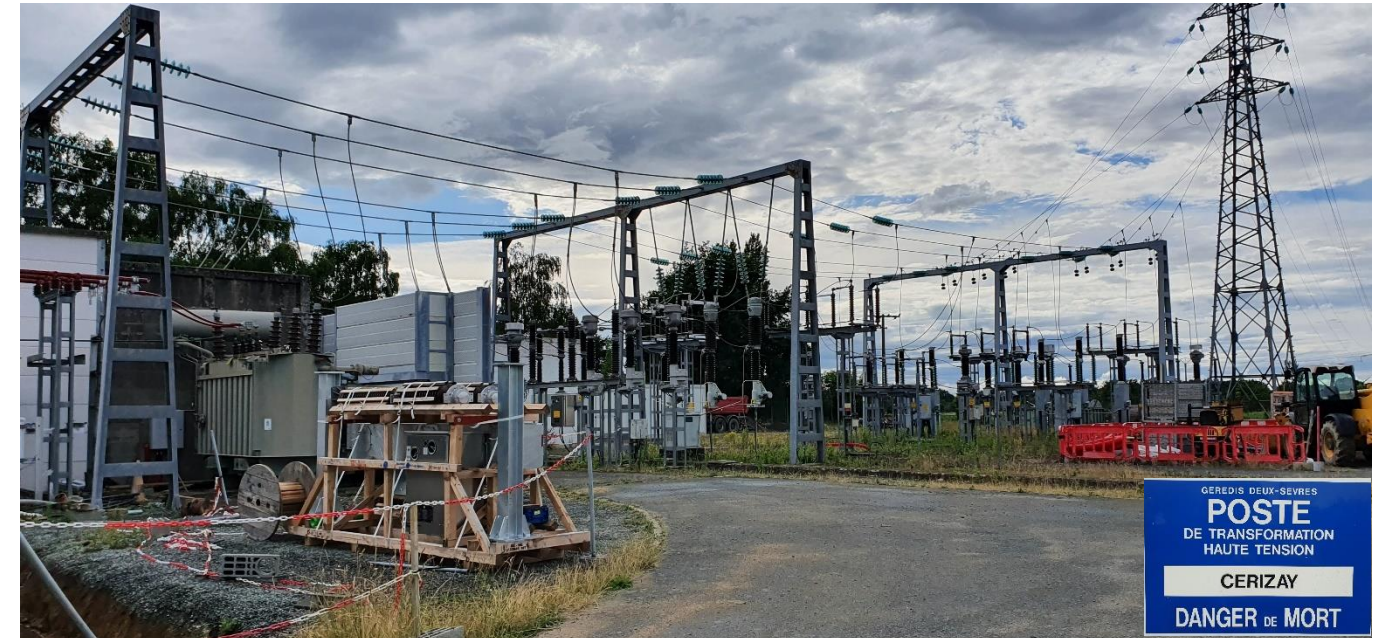
Illustration 25 : Photo du poste source de Cerizay
